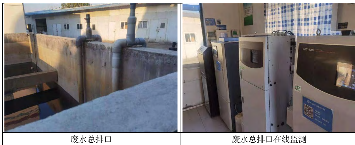
图4.1.1 废水处理装置及排放口照片
