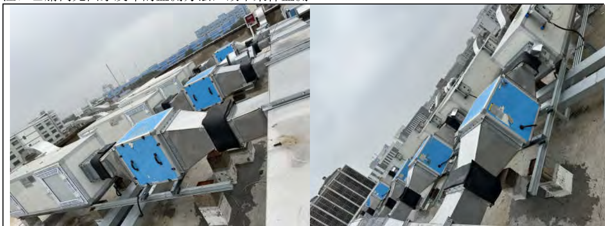
图7.2.1 5#~13#、14#~19#废气处理装置合并现场照片
